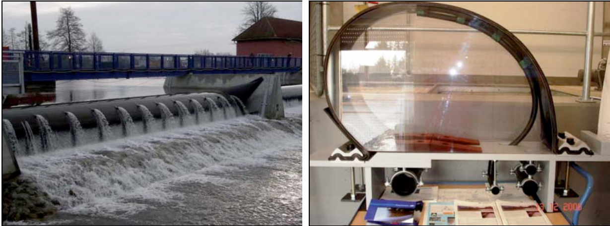
Abb. 2: Inbetriebnahme der Wehranlage Marklendorf an der Aller (links) und Klemmschienen des Wehrs im Modell (rechts) (Meine, 2007)
